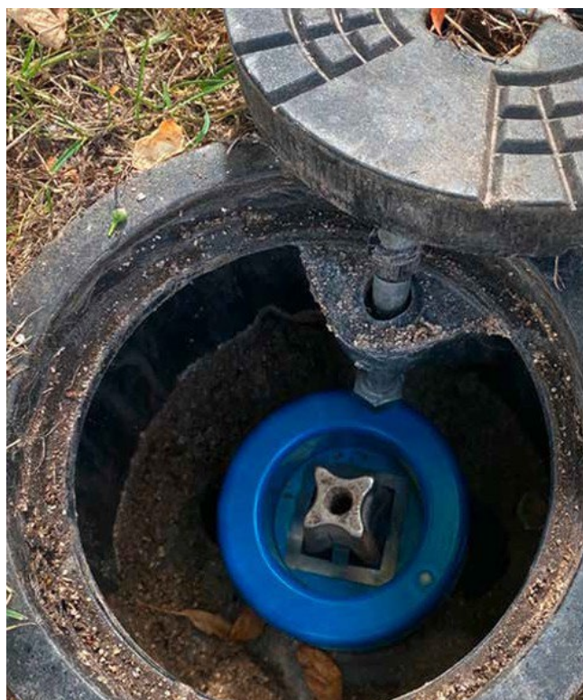
VIDI Pozycjoner zainstalowany w skrzynce ulicznej.
